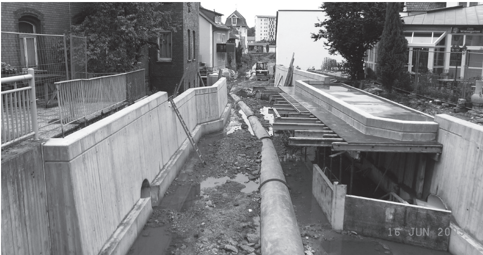
Die Arbeiten an der Hochwasserschutzmaßnahme an der Röden im Bereich zwischen der Brücke Coburger Straße und der Mühlenstraße schreiten kontinuierlich voran.
