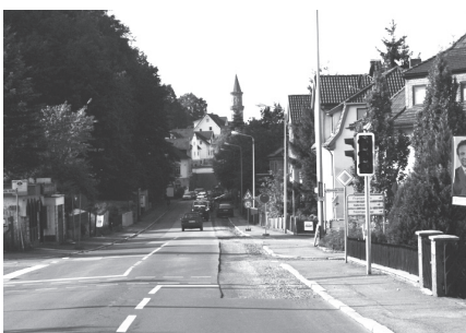
Während der Baumaßnahmen an der Sonneberger Straße wurde der Verkehr über eine Baustellenampel geregelt.
