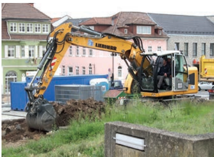
Die alten Bodenbeläge aus den 80er Jahren werden nach und nach ausgebaut um Platz für neuen Granit zu schaffen.
